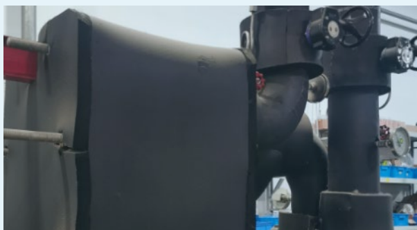
蒸汽冷凝水熱能循環
